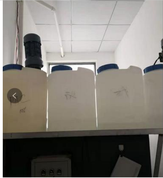
废水处理设施
