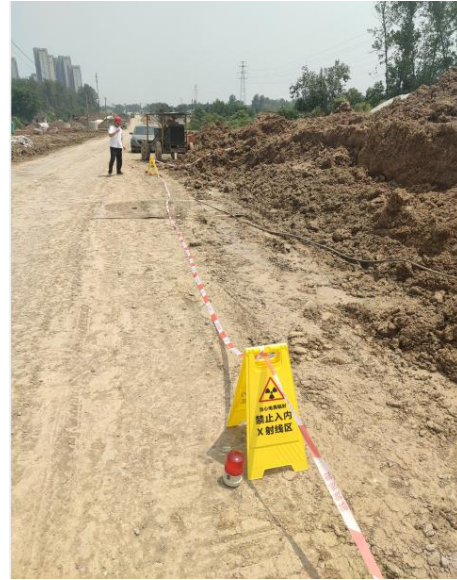
现场警示标志和警示灯
