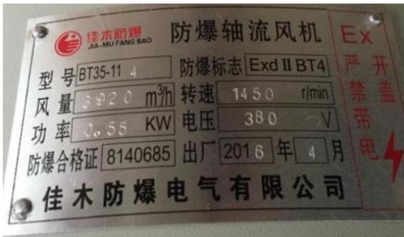
排风轴流风机铭牌
