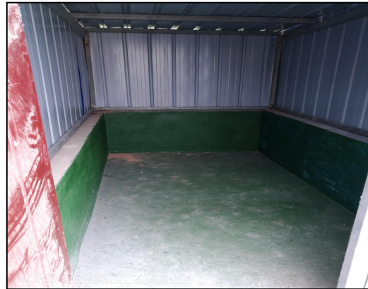
图 3-10 危险废物暂存库内部
