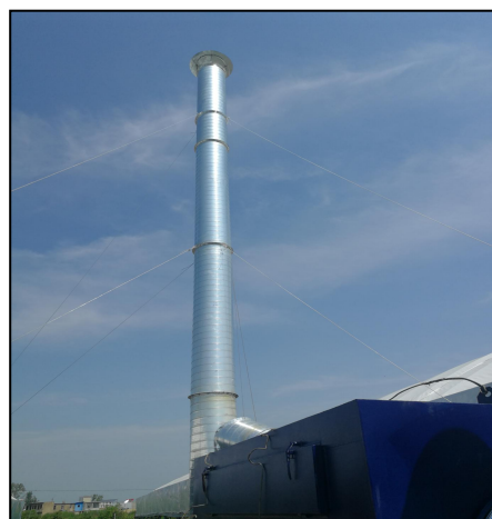
图 3-3 废气处理装置及排气筒
