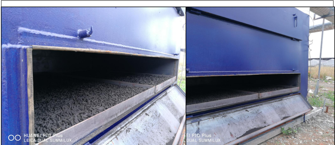
图 3-4 活性炭吸附装置内部
